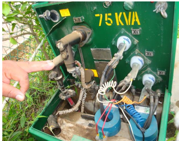
Fig.2 Transformador de la subestación eléctrica subterránea y sus componentes de instalación.
