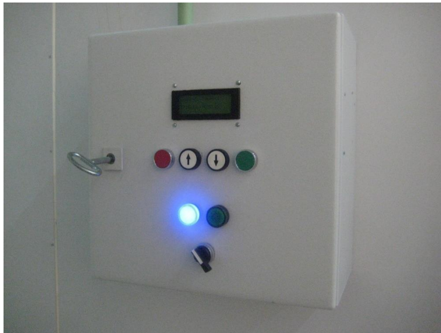
Figura 5.- Vista exterior del gabinete instalado en la empresa.
