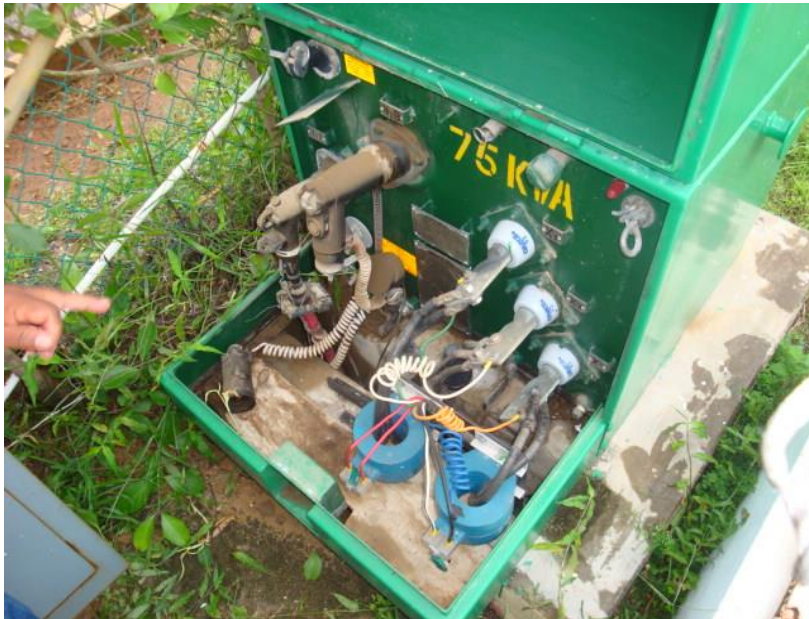
Fig. 4 Transformadores de corriente del transformador.
