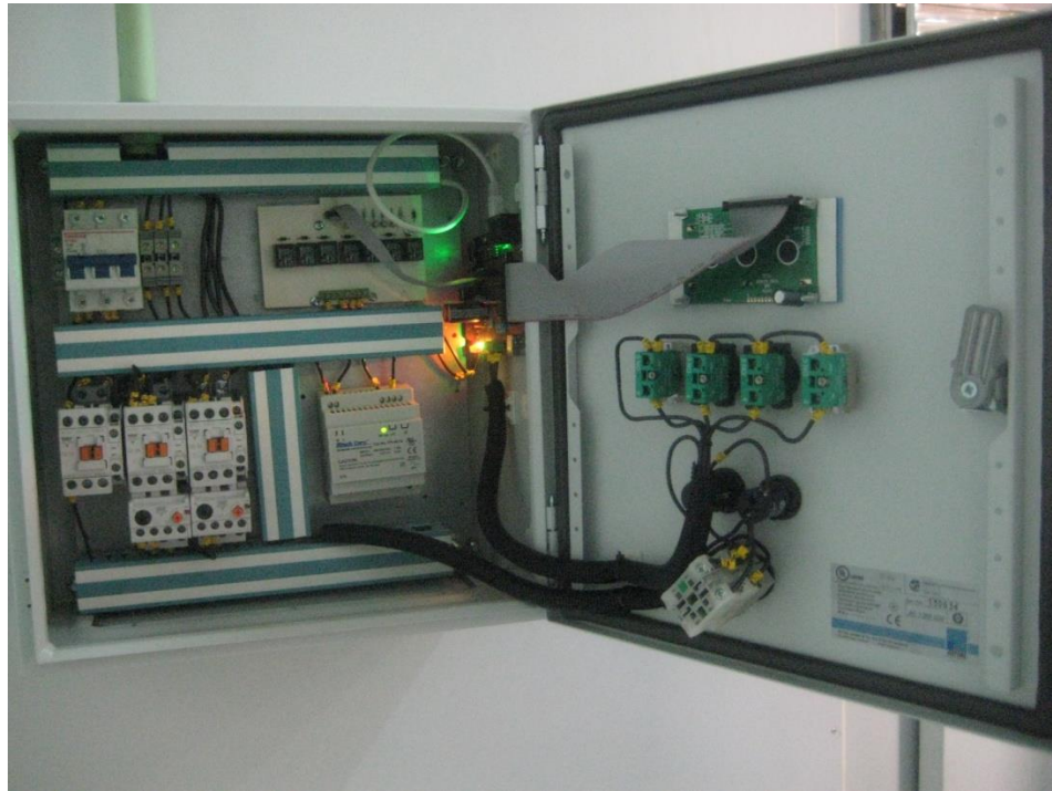
Figura 4.- Vista interna del gabinete instalado en la empresa.
