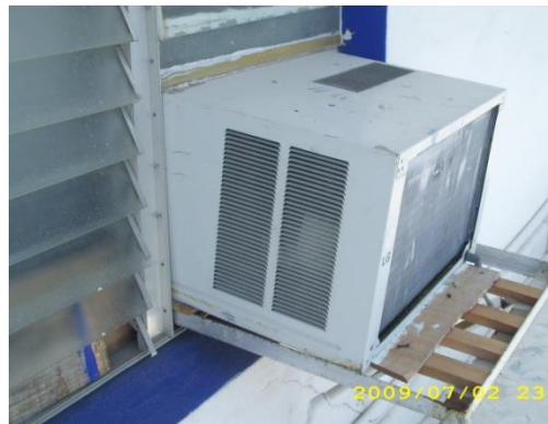
Fig. 1 Equipo de aire acondicionado con fugas de energía debido a una mala instalación y ventanas inadecuadas.
