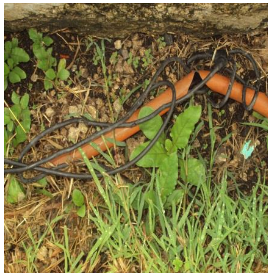
Figura 2. Conductores eléctricos expuestos y uso indebido de poliducto
