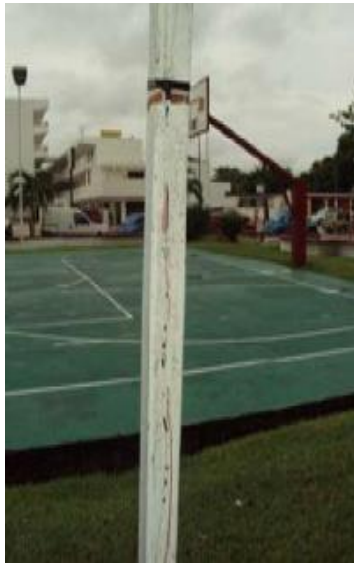
Figura 3 Poste para luminaria con los conductores expuestos
