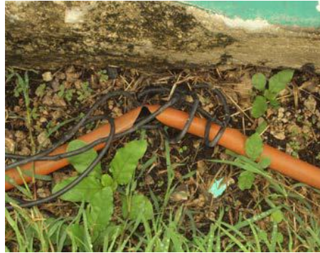
Figura 1. Anomalías detectadas en conductores y tuberías.
