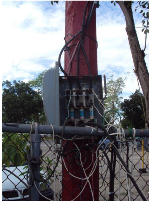
Figura 6. Caja para fusibles expuesta e instalada de forma insegura.
