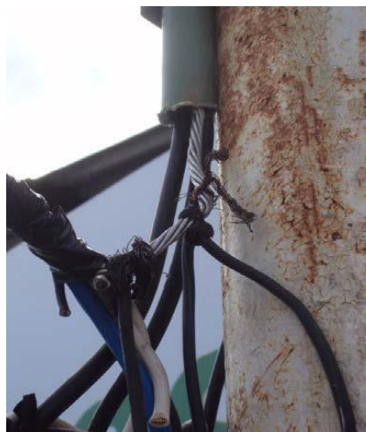
Figura 7. Empalme indebido de conductores.
