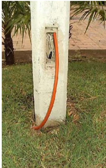
Figura 4. Uso indebido del poliducto y conexiones expuestas.
