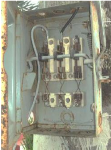
Figura 5. Caja para fusibles expuesta e insegura.
