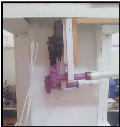
Figura 14- Actuadores para control de flujo de agua y cloruro férrico.
