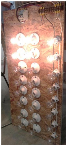
Fig. 6 Carga eléctrica para el generador de inducción
