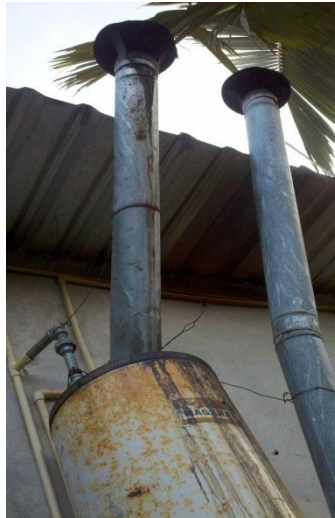
6 Tubos de escape del humo
