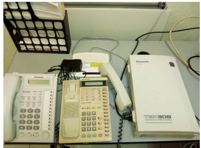
Figura 6. Líneas conmutadas con hilos de cobre.
